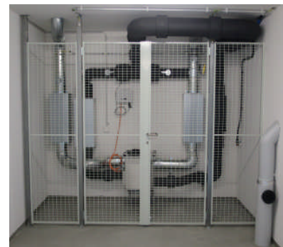
Kellerlüftungsgerät mit Luftentfeuchtungsfunktion
