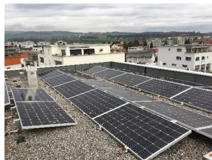
Photovoltaik-Anlage auf dem Dach
