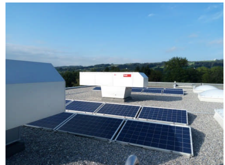
Lüftungsgerät auf Dach
