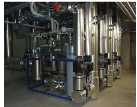
3 Stück Dampf-Warmwasser- Wärmetauscher je 1'000 kW
