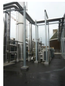
Versorgungsleitungen Klärgas, Produktgas und Dampf
