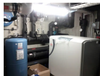
Heizzentrale mit Erdsondenwärmepumpe
