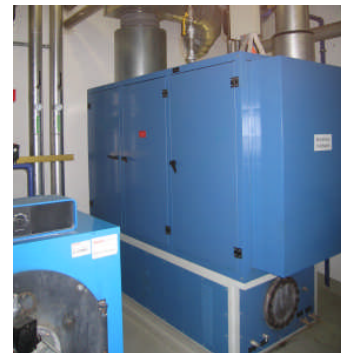
BHKW 90 kW elektrisch
